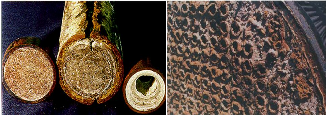
Gambar 5 : Akibat manajemen air boiler tidak sesuai – kecelakaan fatal
