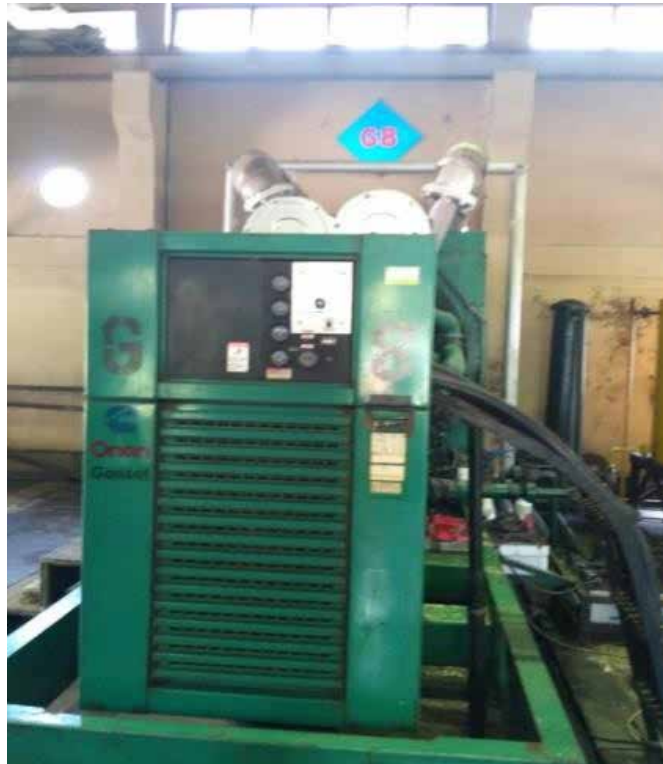
Gambar 1. Generator Set Cummins KTA 38G5 di PLTD PPSDM Migas
