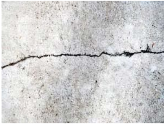
Gambar 1. Keretakan Pada Struktur Beton Bertulang
