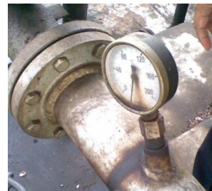
Gambar : 3.1 PI tidak berfungsi
