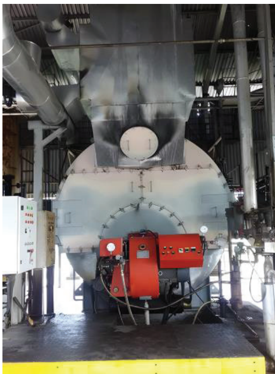
Gambar 1. Tampak Depan Boiler TWA
