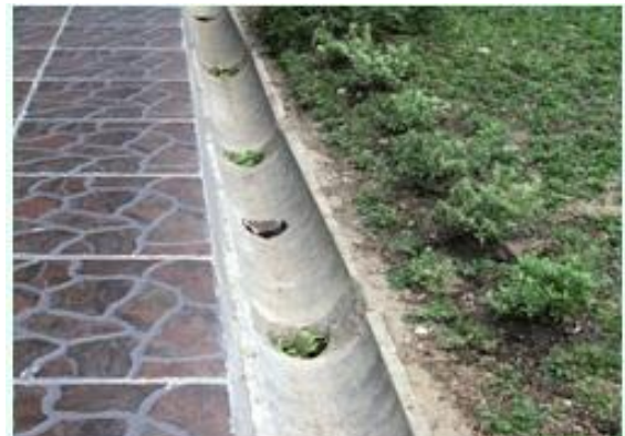
Gambar 7. Biopori Pada Saluran Pembuangan Air Hujan
