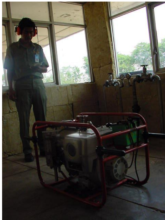
Gambar 6. Pengukuran Fire Pump setelah peredaman
