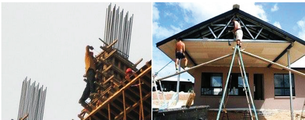
Gambar 2. Tidak menggunakan alat pelindung diri pada pekerjaan di ketinggian dapat menimbulkan kematian pada kecelakaan
