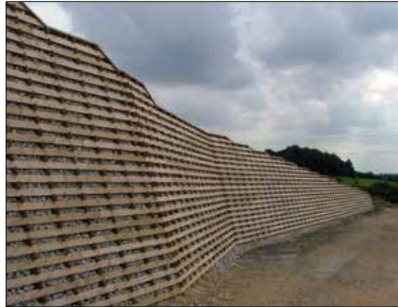
Gambar 5. Timber Crib retaining wall (kanan)
