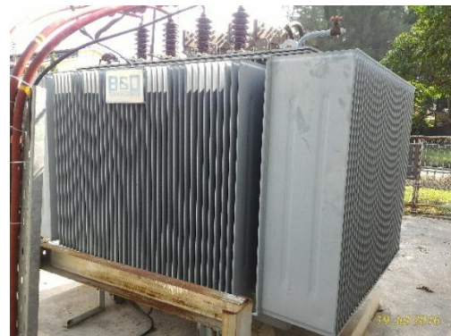
Gambar trafo dari belakang
