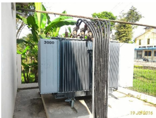
Gambar Trafo dari depan
